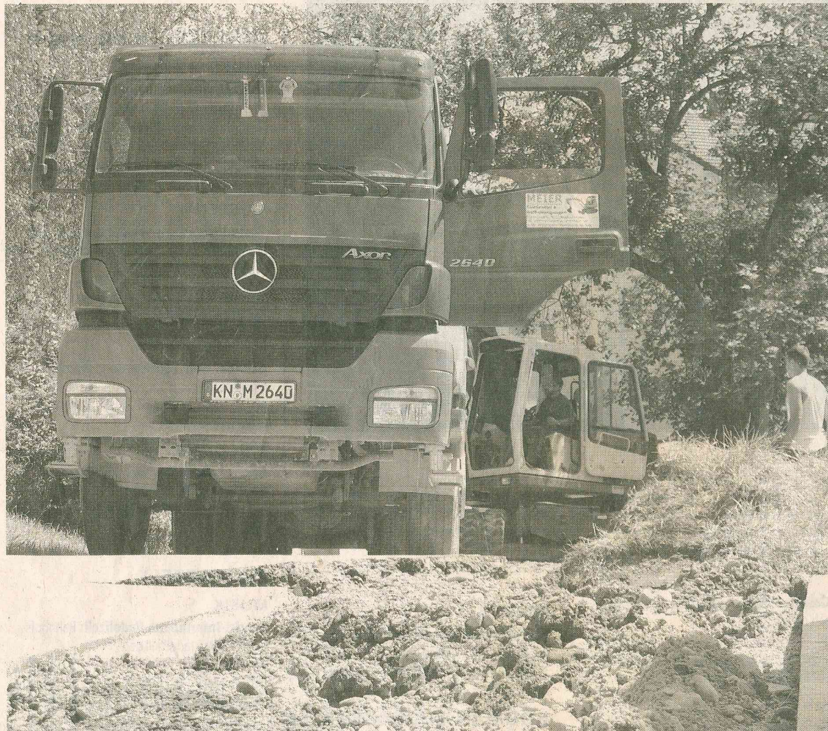
Endlich wird die Baumaßnahme der Straßen Am Bildstock bis zum Schützenweg abgeschlossen. Seit gestern wird wie
