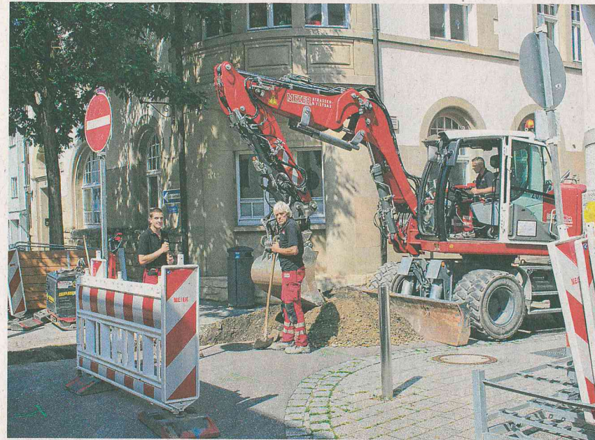
Marco Schweizer (von links), Klaus Friedrich und Baggerfahrer Maik Richard graben die Pfarrstraße auf, wo die Stadtwerke dann neue Leitungen verlegen. BILD: LUKAS REINHARDT
